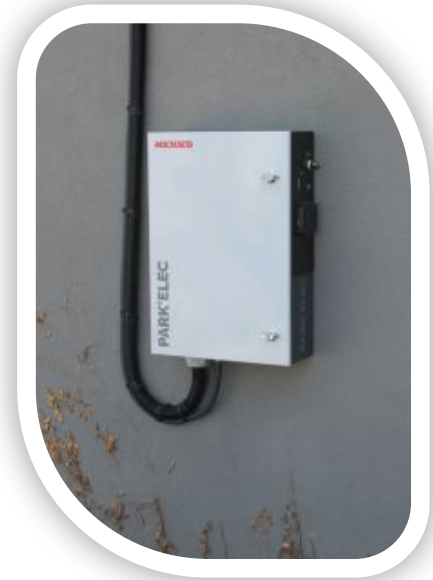
Armoire tout-en-un (Parkbox 7) posée sur mur extérieur
