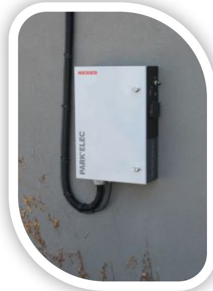
Armoire tout-en-un (Parkbox 7) posée sur mur extérieur
