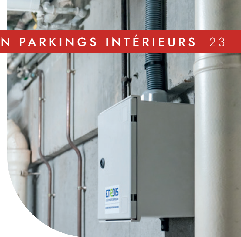
Exemple de coffret d'exploitation
