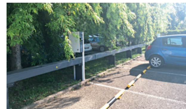
Exemple d'une installation intégrée à la végétation
